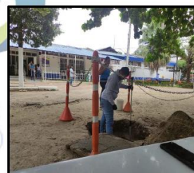
Fotografía 2: Medición de caudal afluente.
