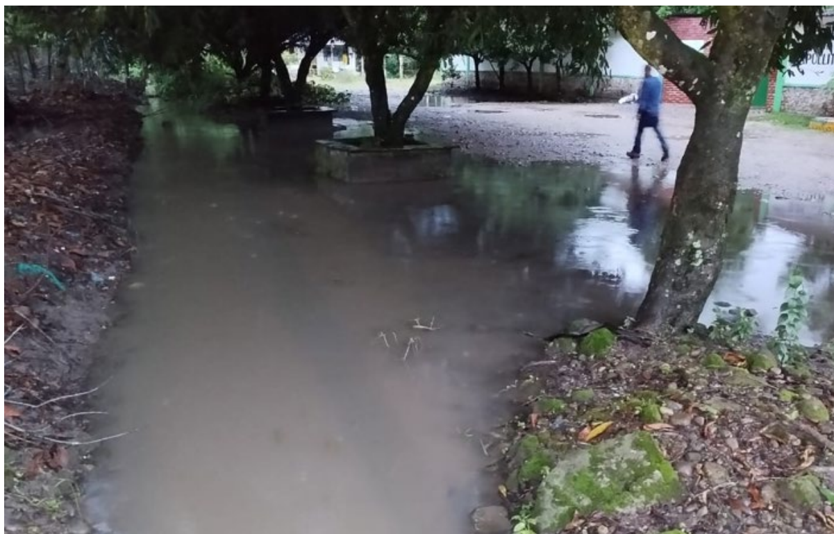
Imagen 3, CANAL EXISTENTE SATURADO
