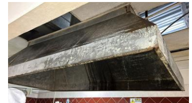
Extractor de cocina un poco deteriorado
