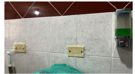
Tomas corrientes tapados con cinta adhesivas.
