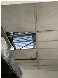
Cielo razo en mal estado
