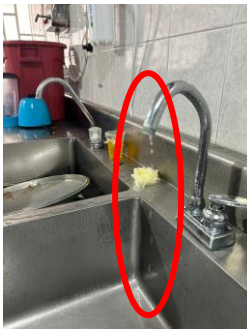
Grifo del agua goteando
