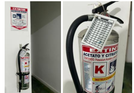
Extintor se encuentra en el comedor
