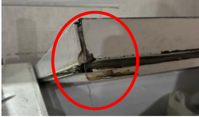
Tapas de los refrigeradores en mal estado
