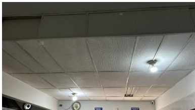
Iluminacion del servicio de la cocina
