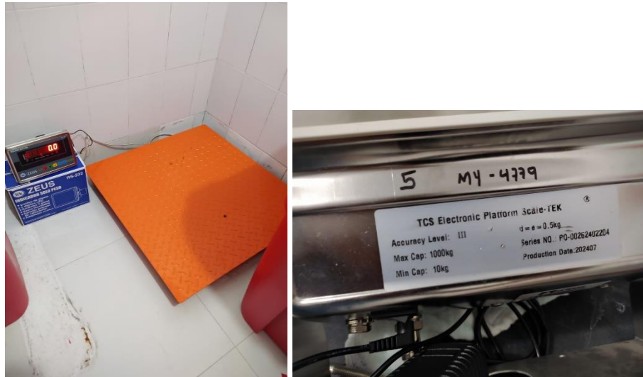
Ilustración 5 Basculas instaladas en la Sede C
